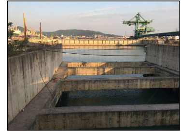
取水口 (ギソン第二火力発電所との 共有施設)
