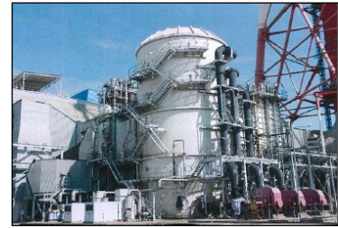
排煙脱硫装置
