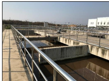
河南省南陽市の汚水処理場
