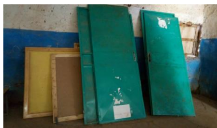
倉庫に保管された外れたドアと掲示板
