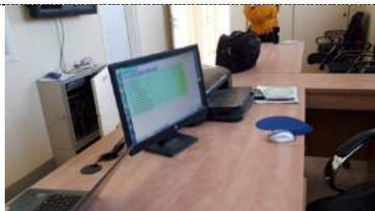
写真 10 : JAIP 太陽光発電 監視室 発電量は表示されていない
