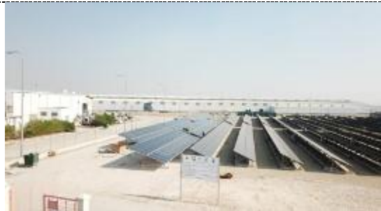
写真 14 : 2020 年 11 月に増設した 平置き太陽光発電設備 (左側 3 列分)
