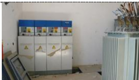
写真 8 : JAIP300kW 太陽光施設用変圧器室
