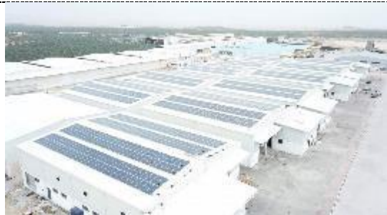
写真 13 : 2020 年 11 月に竣工した新しい 屋根置き太陽光発電設備
