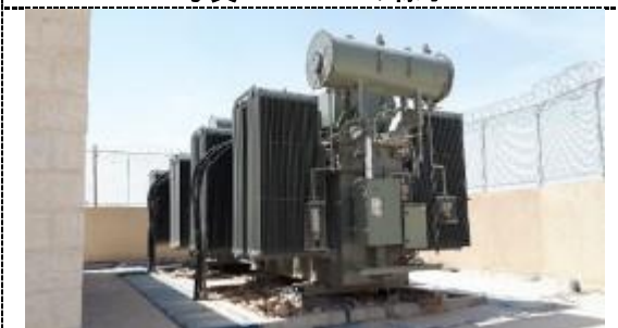
写真 5 : JAIP 専用変電所内 15MW 変圧器 2 台
