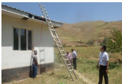
Установка оборудования по раннему оповещению
