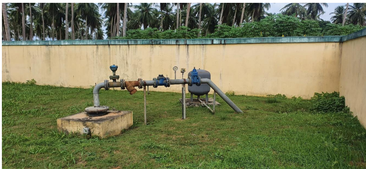
図 46： Assinie 地区の浄水システム試験のサイト候補となる放棄された水源
