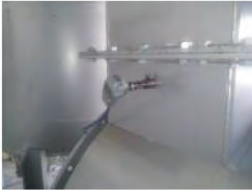
Sensor de temperatura de entrada del horno
