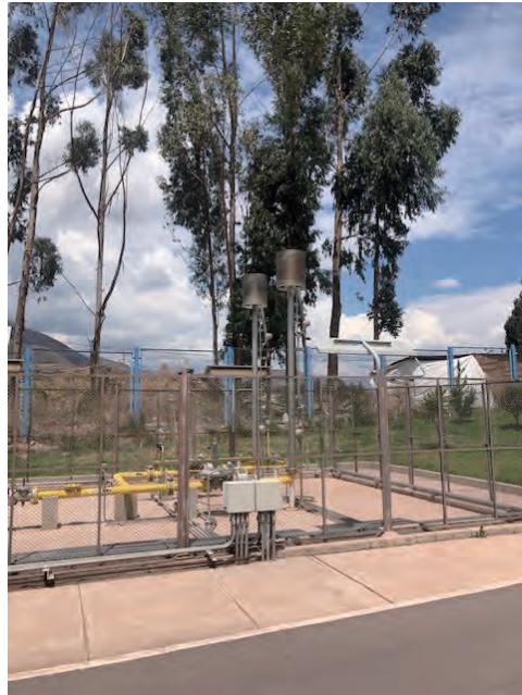
GIZ 支援によるバイオガス発電設備の様子
