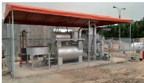
実証機材の全景
