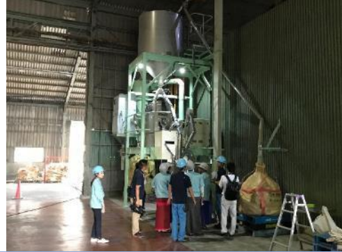
西田精麦、精麦工場設備説明（2019年10月1日、西田精麦工場、八代）
