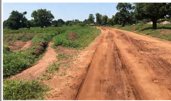
国道 (B 級国道、本プロジェクト対象) (ユンベ ーウレ橋) 未舗装であることから、降雨後に車両が通行する と道路路面が乱れる。
