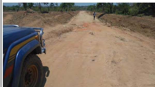
支線道路（フィーダー道路2、本プロジェクト対象外）（国道・ゾーン3、4側） サグ部で路面の凸凹が激しい。
