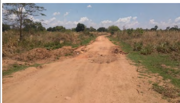
支線道路（フィーダー道路2、本プロジェクト対象外）（国道・ゾーン3、4側） サグ部で路面の凸凹が激しい。
