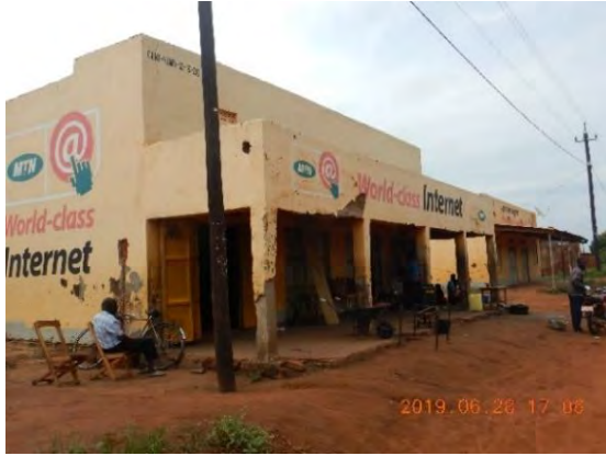
図 2-2. 28 移転が必要な構造物
