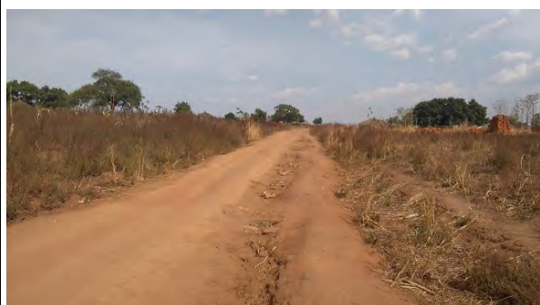
支線道路（フィーダー道路3、本プロジェクト対象外） 側溝がないため、縦断方向に溝ができています。
