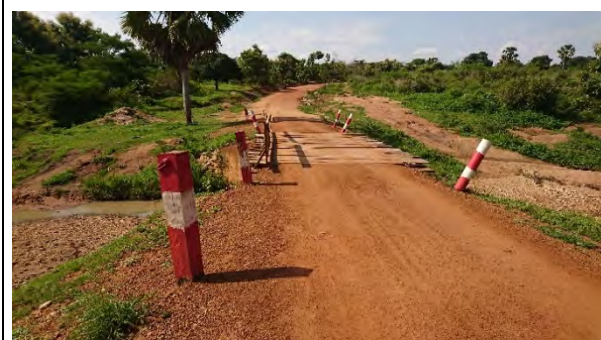
ジュレ橋 (本プロジェクト対象の国道上) 暫定的に通行できるように仮補修済みである。
