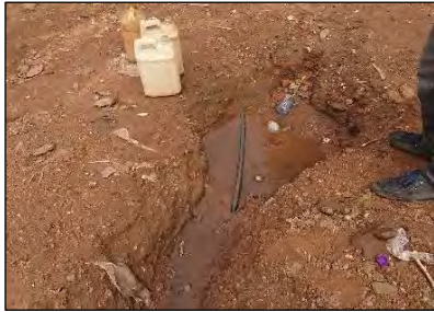
図 2-2.3 水道管の漏水 （国道（B級国道））
