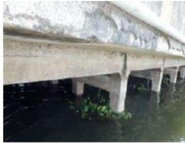
コンクリート剥離とひび割れ
