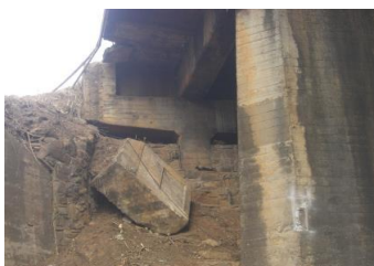
橋梁コンクリート損傷落下
