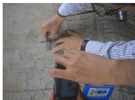
橋梁のひび割れ調査、0.2mm 程度でアルファテック 380 にて補修可
