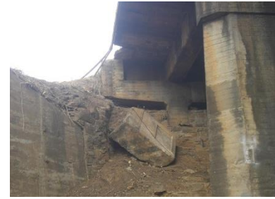
橋梁コンクリート損傷落下
