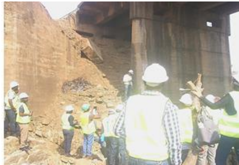
橋梁コンクリート損傷落下中
