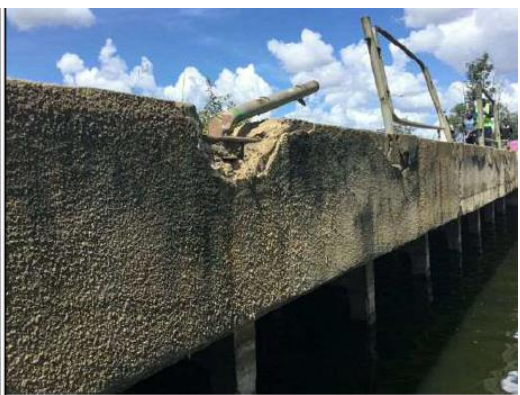
11) 手すりと支柱の損傷
