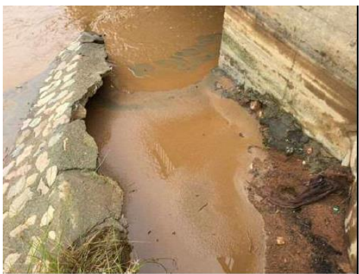
10) 斜面保護損傷
