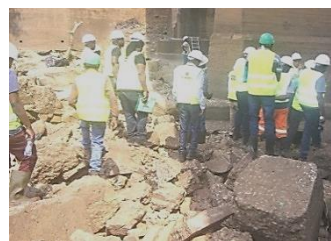
橋梁下は石が散乱し足場が悪い
