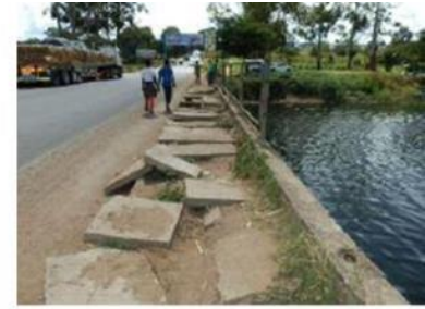
歩道部の損傷
