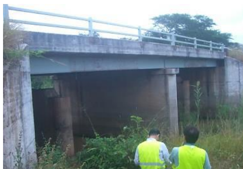
ルサカ近郊の橋梁調査、維持管理があまりされておらず損傷が目立つ
