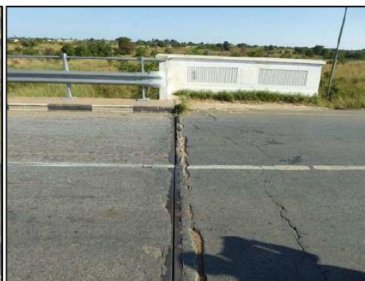
7) 伸縮装置損傷
