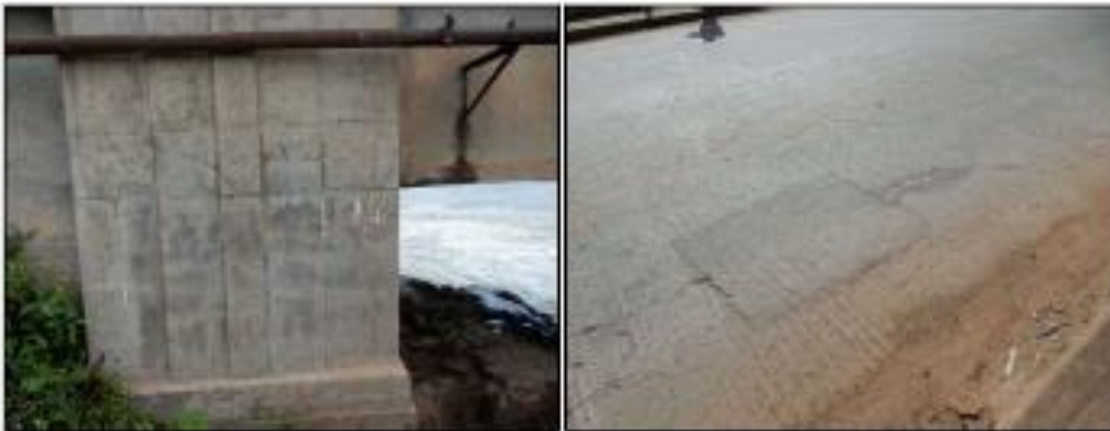
1) 橋台ひび割れ
