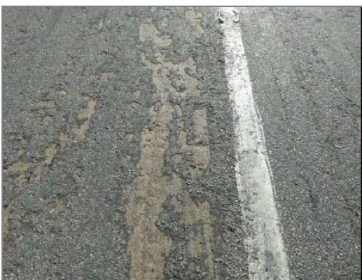
8) アスファルト舗装損傷
