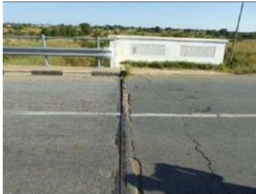
伸縮装置の損傷
