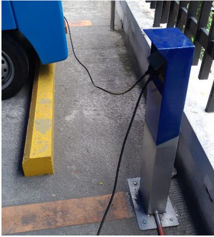
テスト運行の給電設備 (2017年5月)
