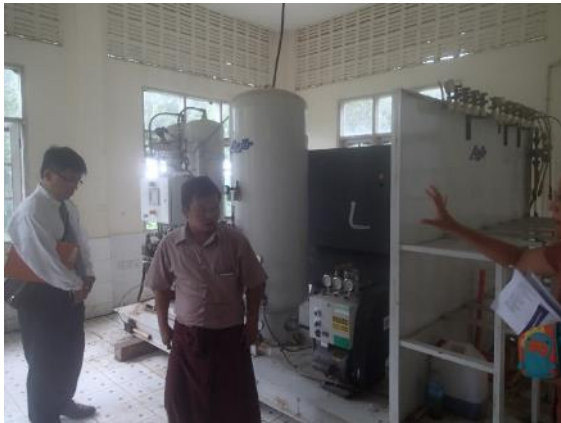
写真 1.8 医療酸素生成プラントにおける ジェネレータ
