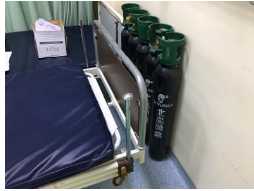
在宅シミュレーション用に Thanlyin 病院 で設置したボンベ (2019 年 3 月)
