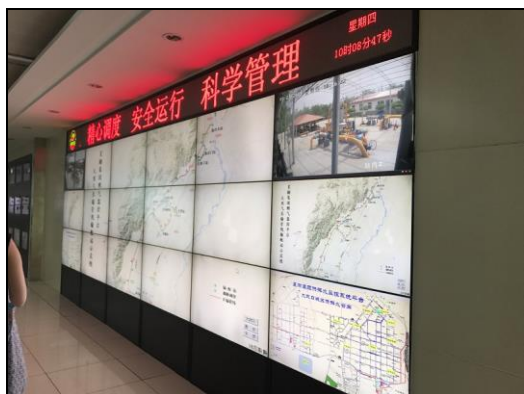
実施機関中央制御室(石嘴山市)
