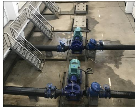
本事業で整備された送水ポンプ設備
