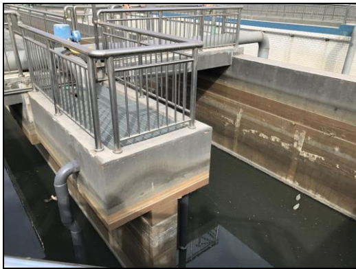
稼働停止中の第3下水処理場
