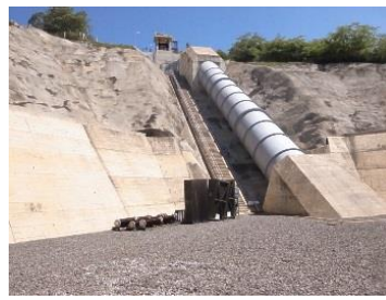
①水圧管と②発電所
