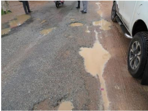
地方道の欠損状況- 1
