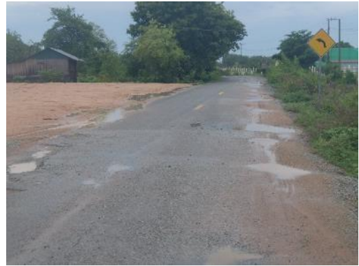
地方道の欠損状況- 2
