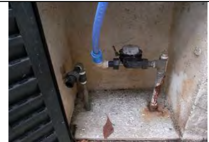
住宅の水道メーター。左は古いもの。右は新しいもの
