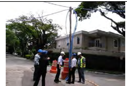
水道管のバイパス（水色のパイプ）。テストが終了後、撤去する
