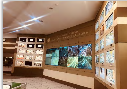
写真：緊急情報センターのモニターシステム
