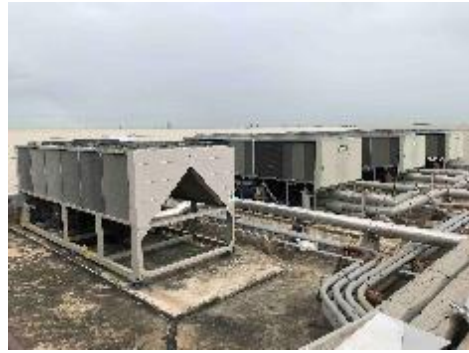
既存の空冷ヒートポンプ (国立地質博物館)
