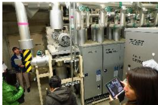
本邦受け入れ活動 (水冷ヒートポンプ) 猪苗代町庁舎
