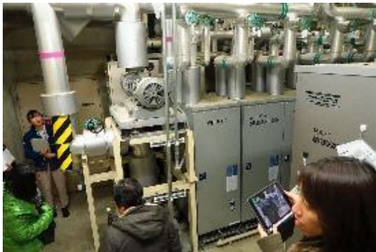
写真 10 猪苗代町庁舎 水冷ヒートポンプ
