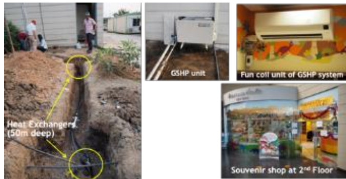
写真 2 CCOP 地中熱冷房システム試験
