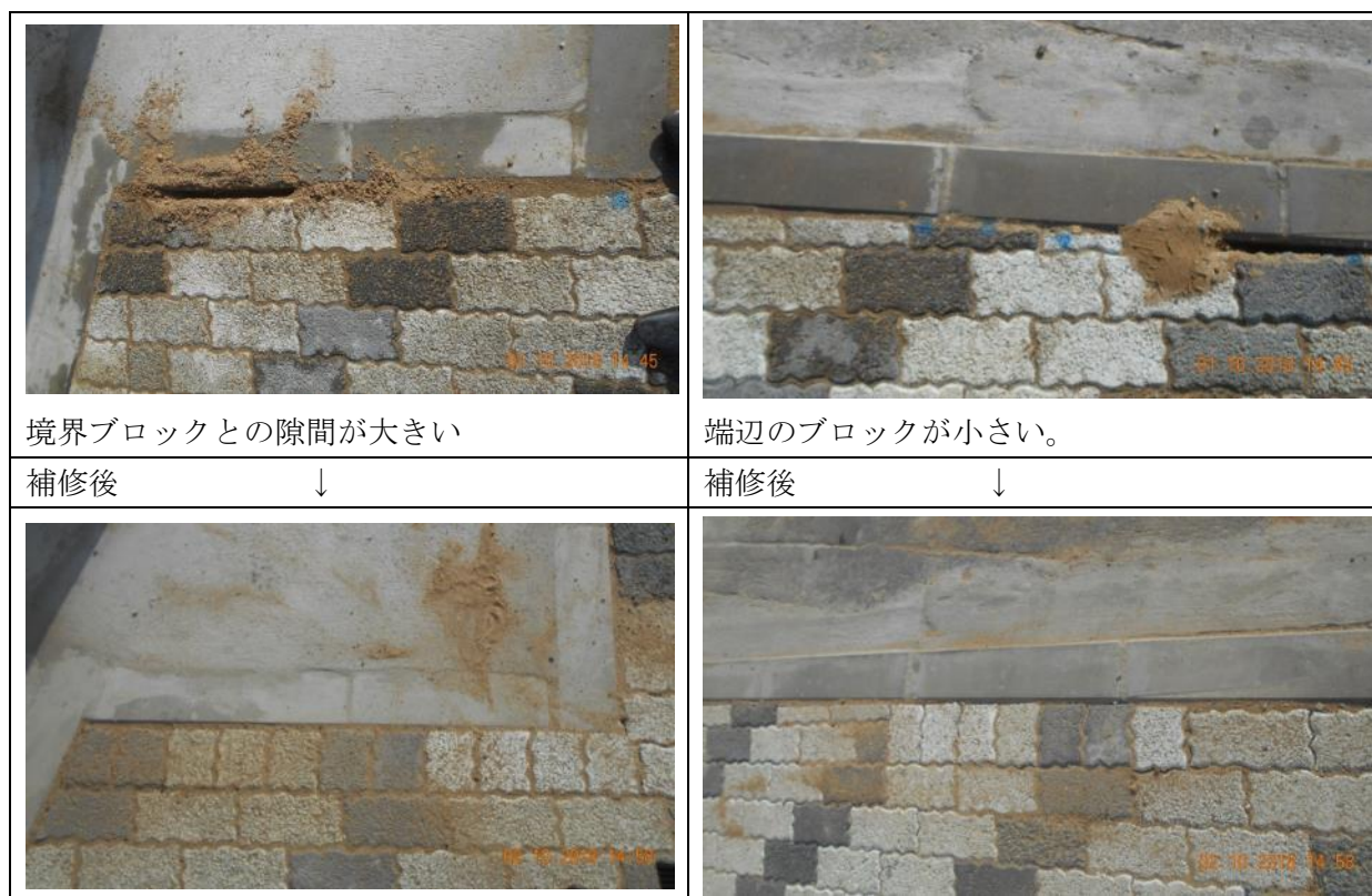
図 3-15 PP 都 DPWT 入口の検査時と手直し後の状況
