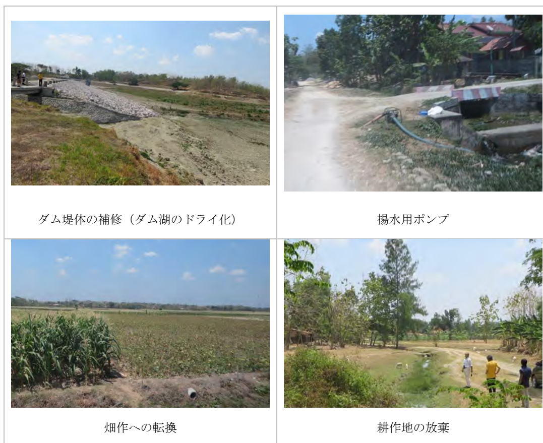
写真 3 灌漑用ダム劣化による耕作被害の状況（Sanggeh ダム）
