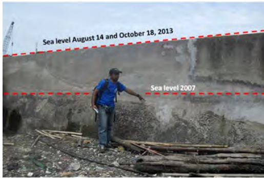
ジャカルタ湾の地盤沈下進行状況
