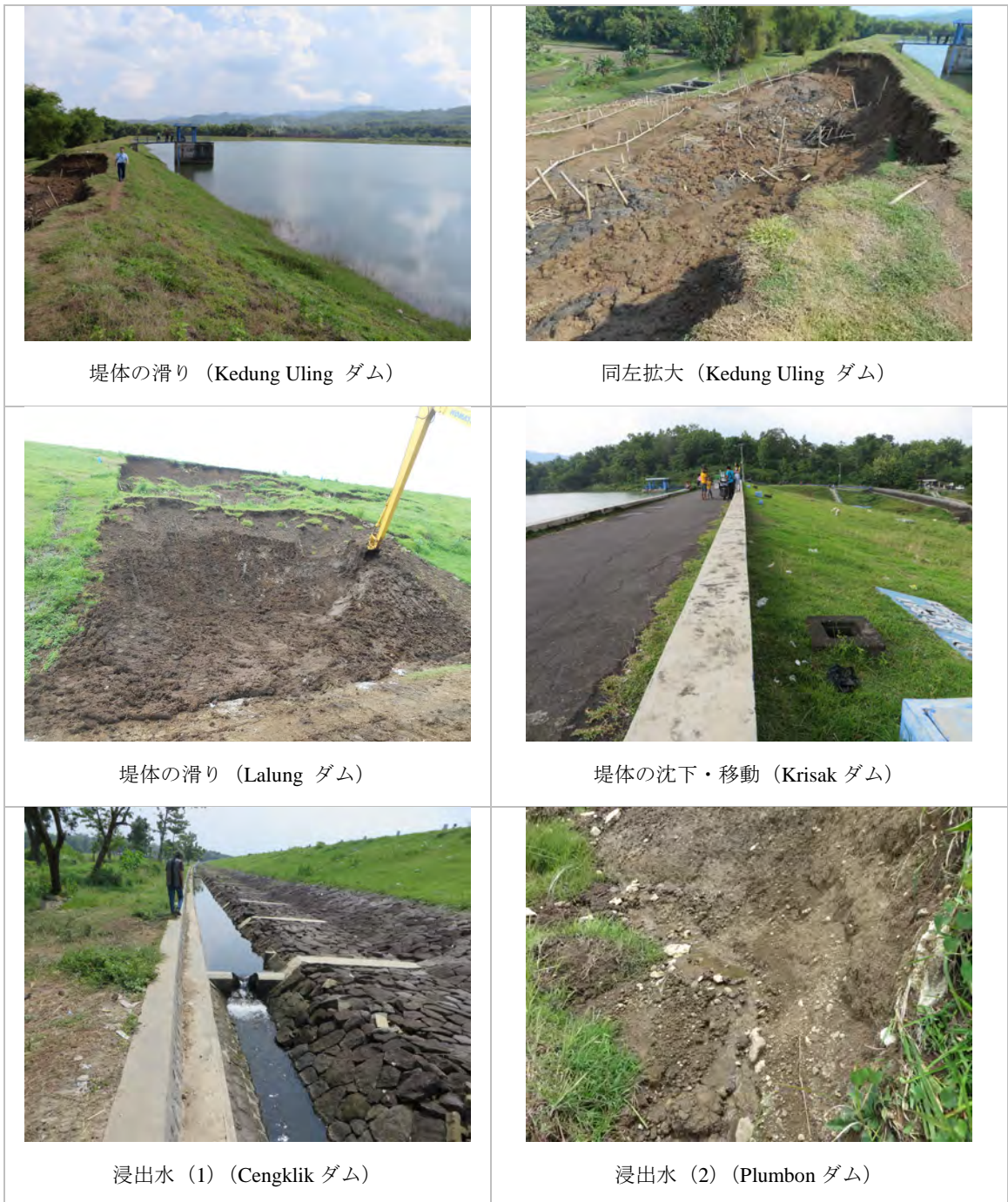
写真 1 灌漑用ダムの劣化状況（ソロ川流域）
