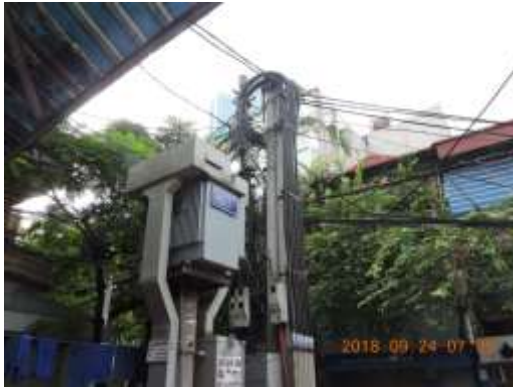
Máy biến áp phân phối treo trên cột bê tông
