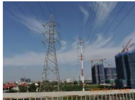
Đường dây truyền tải 110kV và 220kV (tw-1 và tw-2)
