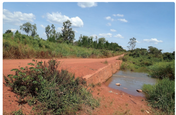
整備されたアクセス道路と河川横断・道路排水施設(オモロ県)
