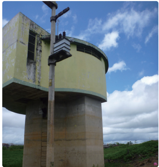
本事業で建設したポンプ場
