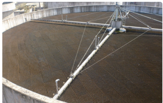
下水処理場（散水ろ床部分）
