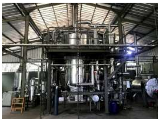
パイロットプラント (50kW ガス化炉)
