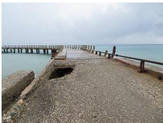
汀線付近の棧橋損傷状況
