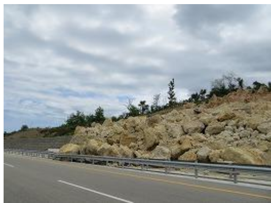
Suai Beacsu 高速道路 (Suai 方面) 斜面崩落部
