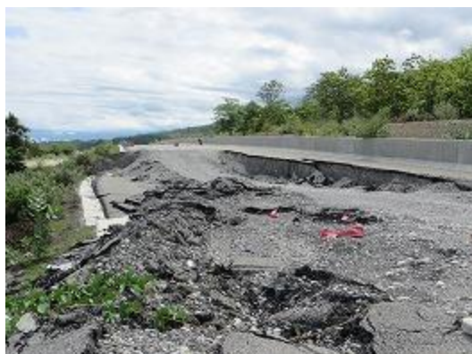
Suai Beacsu 高速道路 (Suai 方面) 道路崩壊部
