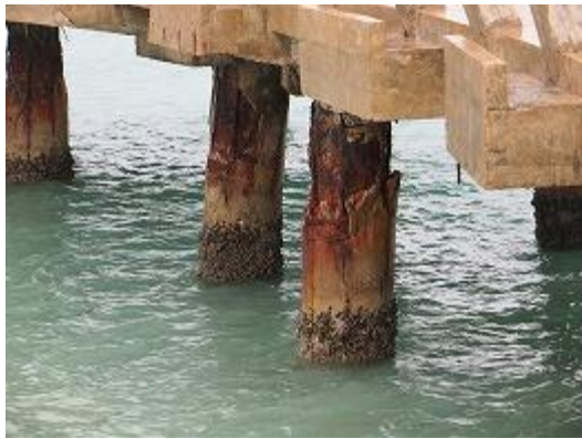
栈橋通路部の杭の劣化状況
