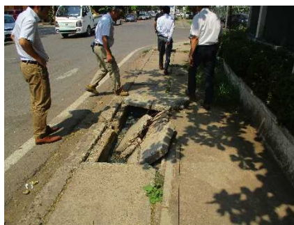
都市部側溝の視察 2019 年 3 月
