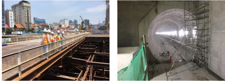
写真-2.2 ホーチミン市都市鉄道 1 号線・地下鉄工事現場（調査団撮影）
