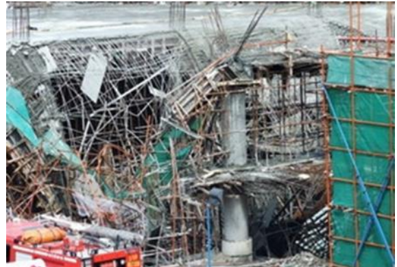
写真-12 ベトナムでの事故例(建物基礎掘削, 2017) (2019年11月26日、提供:MOC)
