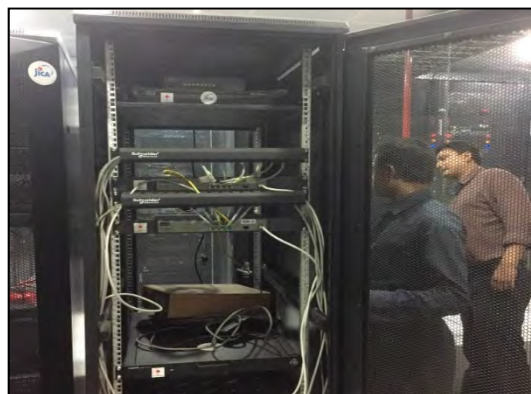
クリアリングハウス銀行のデータセンターに 設置されたサーバ機器
