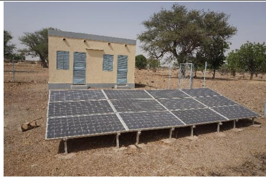
6. 水中ポンプの動力源の太陽光パネル
