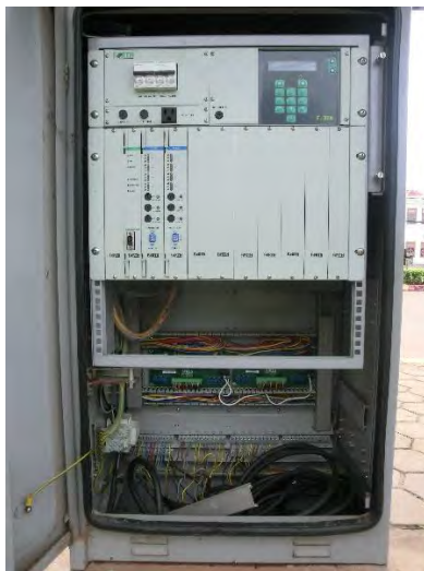
制御機の内部様子 5 (FORTH 社)
