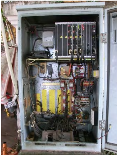
制御機内部の様子 1 (TYCO 社)
