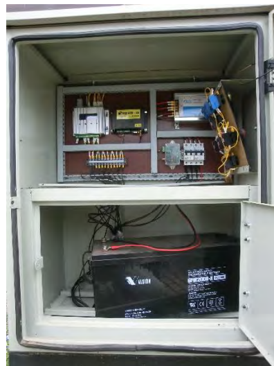
制御機の内部様子 6 (ベトナム製)
