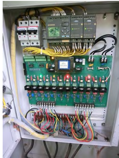
制御機の内部様子 4 (SIEMENS 社)
