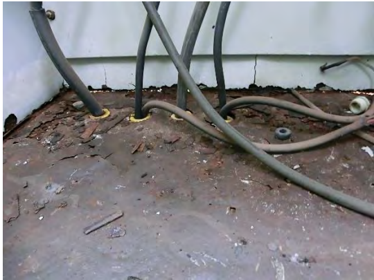
制御機筐体内の腐食
