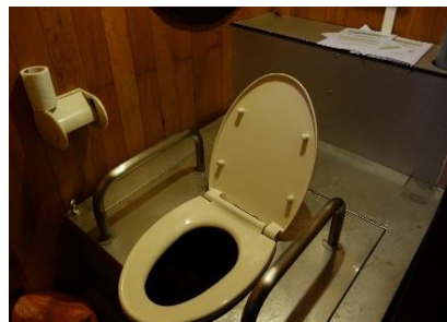
Nhà vệ sinh sinh thái đã lắp đặt
