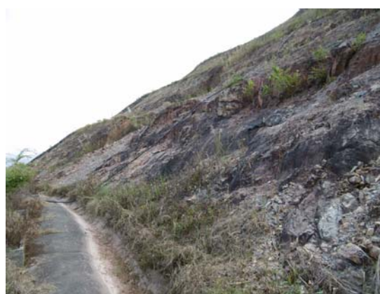
パイロットサイト (崩壊状況) (2017年12月2日)
