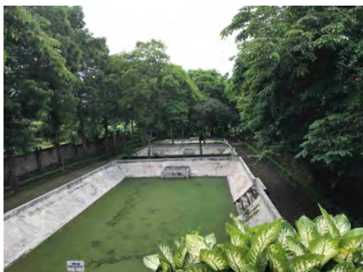
写真 7 浸出水処理の集水池
