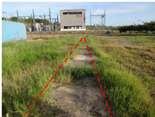
写真 3-7 既設ケーブルトレンチ(2)
