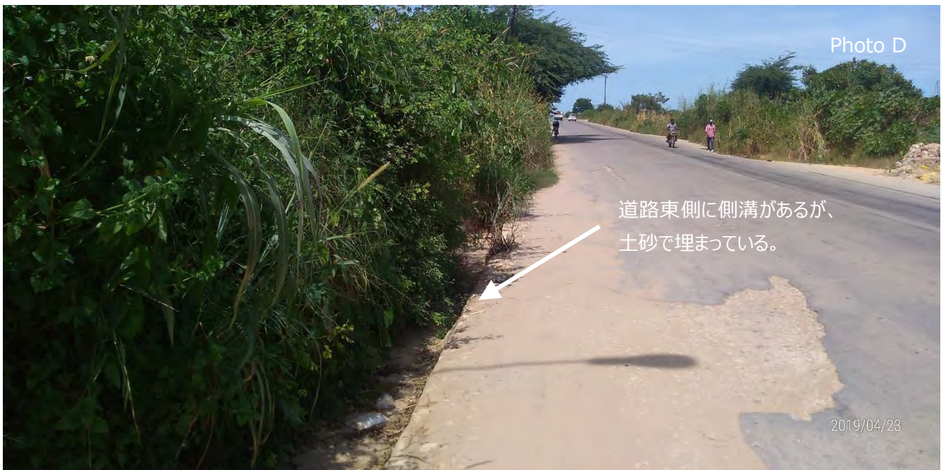
道路の東側に側溝があるが、土砂で埋まっており、排水溝として機能していないと考えられる。
