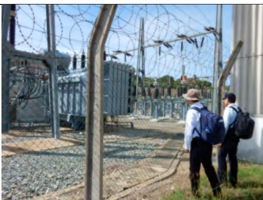
写真-5 既設ナカラ変電開閉施設
