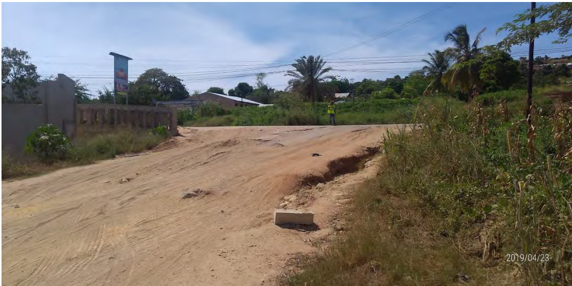
舗装路から西にサイトへ向かう未舗装路 1（勾配があり荒れている）
