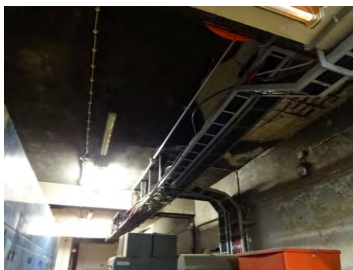
写真 3-4 既設ケーブルルート
