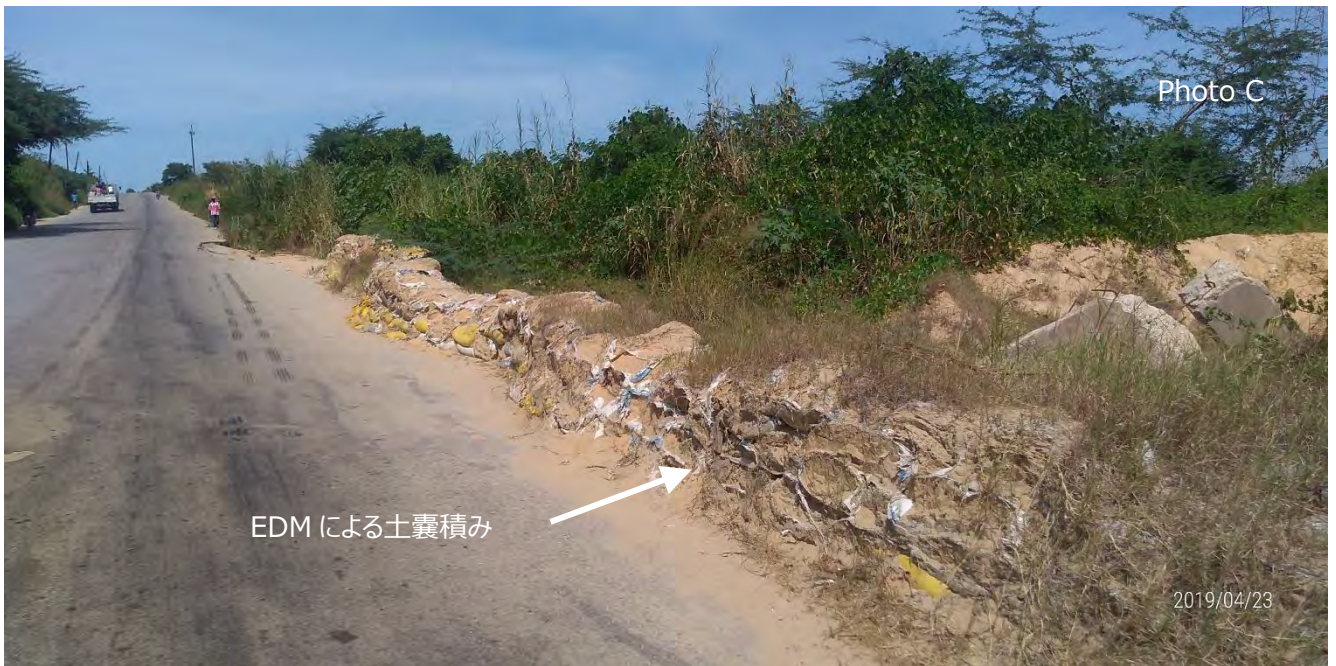
EDM は緊急的な防護措置として道路端に土嚢を積んだようだが、既に紫外線による損傷が発生しており、復旧措置等が必要となっている。
