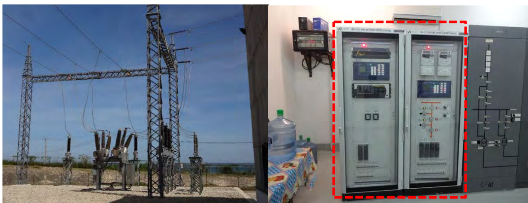
写真 3-2 バージ船用受電開閉設備及び保護・制御盤
