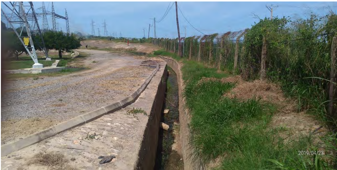
Photo4 : サイト西側の排水溝
