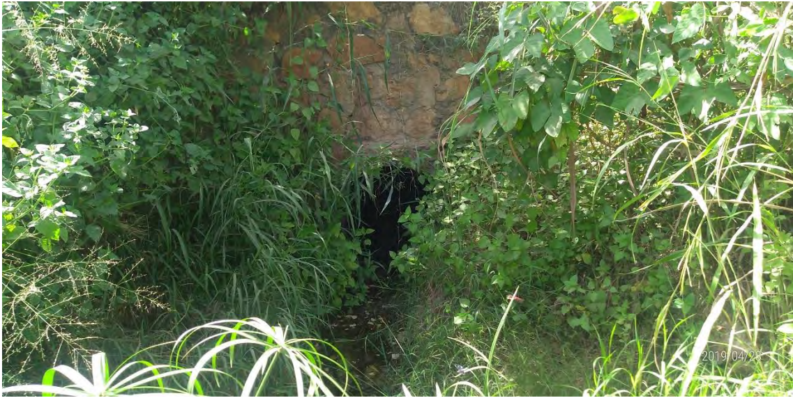
Photo1 : サイトからの排水管出口 (サイト西側敷地外)
