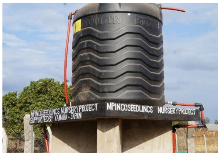
図 2-38 施設区画内に設置した貯水タンク
