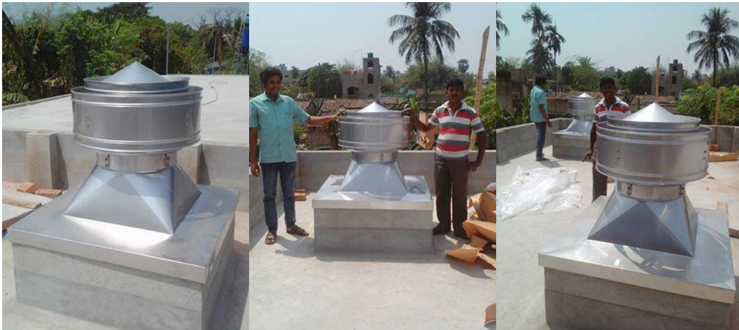
(写真 36~38 : 蓄電室の屋根に設置されたベンチレーター、蓄電室の庫内を一時間に 6~10 回の自然排気を行う。)
