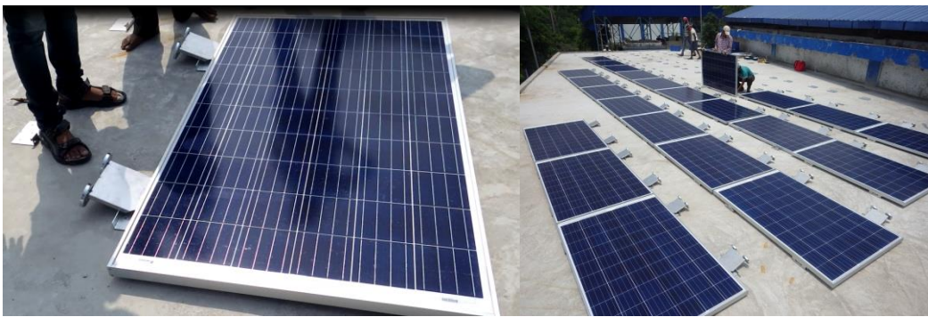
(写真 57、58: マグネット組み立て品を屋根の金具に装着する前の様子)
