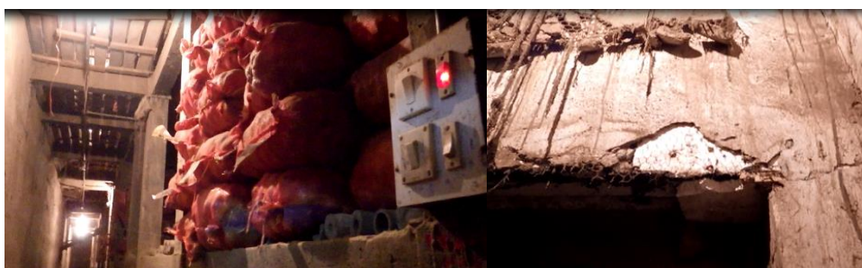
(写真 121: ジャガイモ専用の冷蔵倉庫の内部の様子(左)、写真 122 : カビだらけの壁面、断熱用の発泡スチロール材が露わになっている(右))
