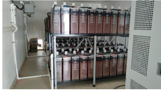
バッテリー庫内
