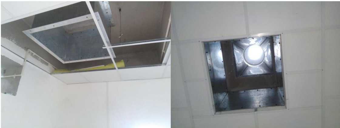
(写真 39、40：ベンチレーターの排気路として吊り天井内部に取り付けられたスチールの板の様子)
