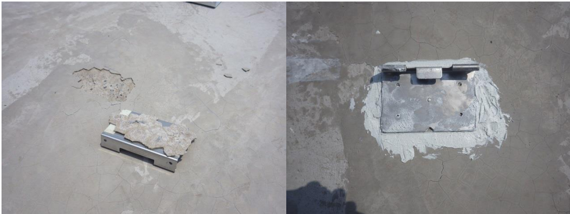
(写真 49: 屋根の表面から剥がれた金具 写真 50: 剥がれた金具を修復した様子)
