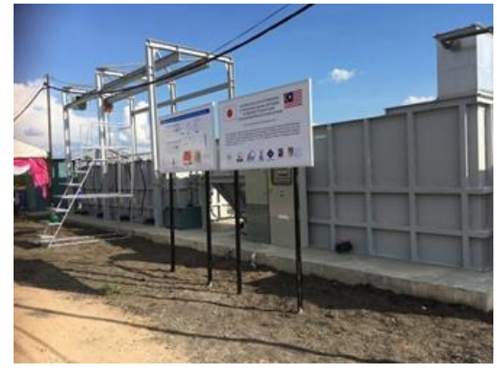
排水処理装置の全景 （2018年4月）
