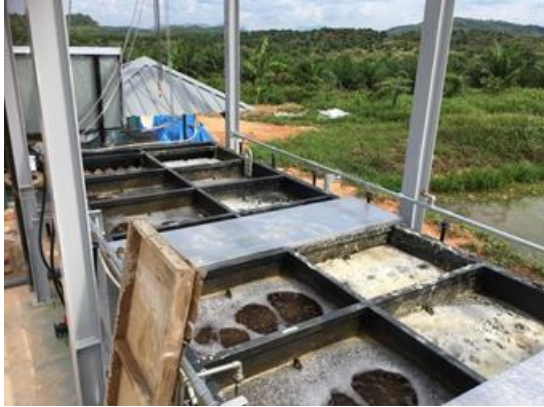
排水処理装置（脱色・脱臭槽） （2018年4月）
