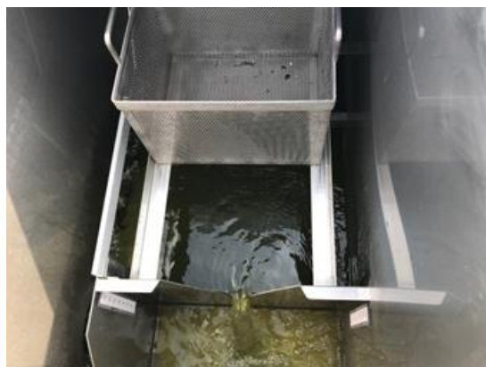
計量槽の流入水位レベル
