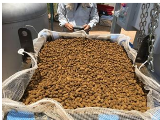
脱色・脱臭槽に詰め込まれた 阿蘇リモナイト (2018年3月)
