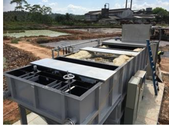
排水処理装置（接触酸化槽・沈殿槽） （2018年4月）
