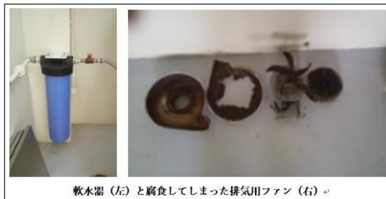
図2-9 黒ニンニク熟成機のための軟水器と腐食した換気用ファン (出所：JICA 調査団作成)
