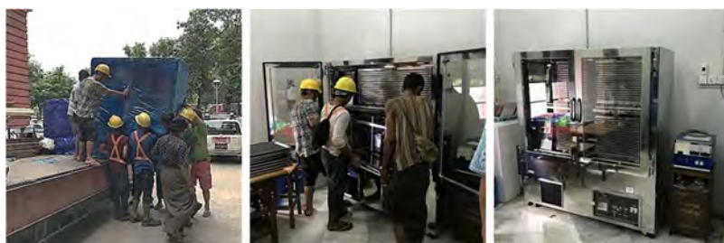
図 20 YGH 据付機材
