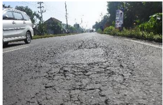
道路面の膨張土による被害状況 (7/30 IRE 提供)
