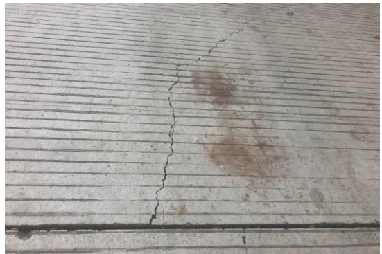
インドタイセイ工業団地内の道路のひび割れ (3/13)
