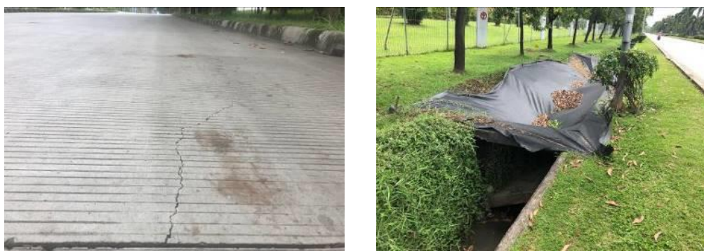
図 34 膨張土による現地被害状況（現地写真）
