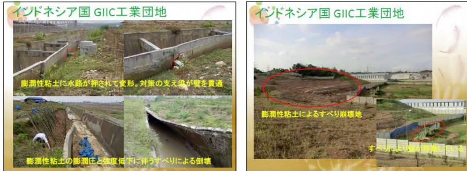
図 7 日系工業団地（GIIC）における膨張土による法面等の被害状況
