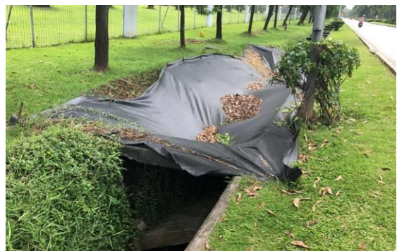
KIIC 内の側溝。膨張性粘土の影響で破壊されている (3/13)
