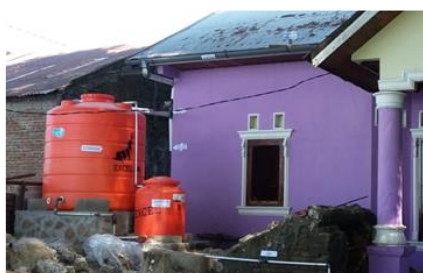
小島に設置した現地雨水貯水槽
