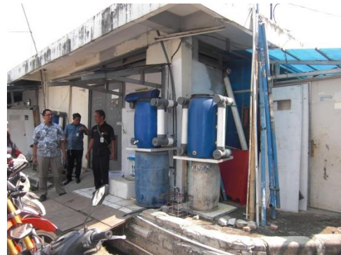
ATMAJAYA 大学、州政府と共同設置した貯水槽
