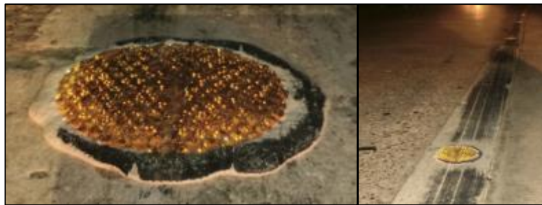
図 2-6 高い耐久性（ヤンゴン市北部ケイビンランの施工箇所） 左／施工後半年を経過しても破損しない耐久性 右／大型車のブレーキでも剥がれない
