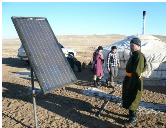
ゲルに設置されたソーラーパネル
