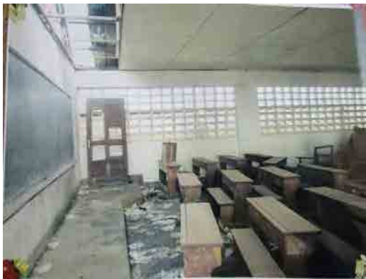
写真 1 放火された教室
