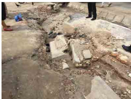
写真4 豪雨で崩壊した側溝と歩道
