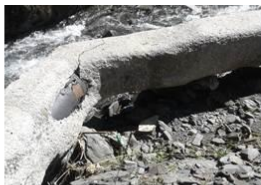
写真 5. 洪水により保護材に損傷を受けたナムリマイラの導水管
