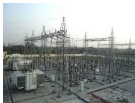
写真1. 変圧器と送電設備 (メグナガット 132/33 kV 変電所)
