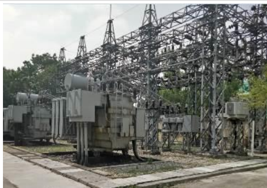
改修された変電所（Tangail、シレット）
