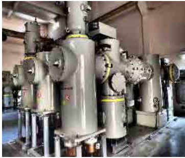
GIS ユニット(パティガダ変電所)
