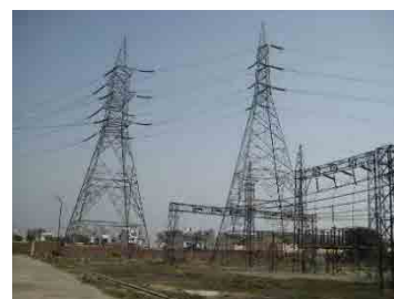
送電線 (Shamalhka 変電所)
