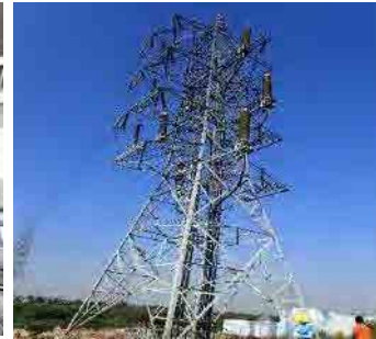
220kV 送電線 (ハヤサナガール～ ガナプール変電所間)
