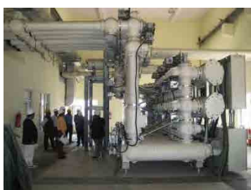
Sector 20 (Gurgaon 地区) 変電所 ガス絶縁開閉装置 (GIS)
