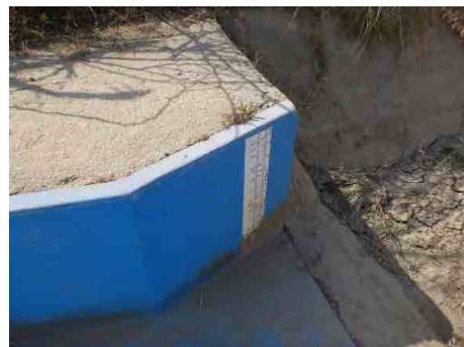
本事業で設置した水量計
