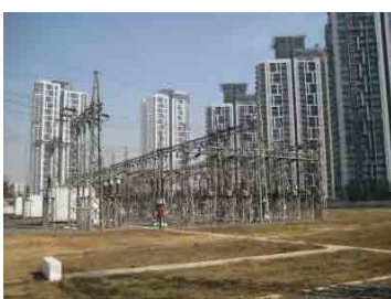
Sector 72 (Gurgaon 地区) 変電所
