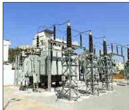
本事業で整備されたムサランバ変電所
