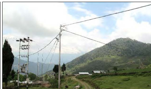
本事業の配電変圧器と 33kV 配電線 (モンガル県ナラン・ゲオッグ 2 )
