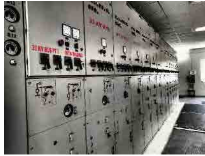
バルカンペット変電所の制御盤
