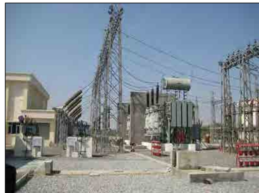
Sector 20 変電所 (グルガオン地区)
