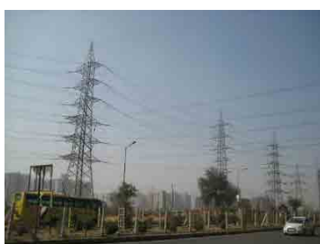
送電線 (Gurgaon 地区)
