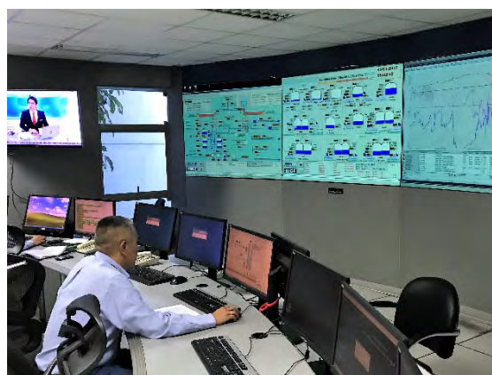
SCADA 管理室 (SEDAPAL 本部)
