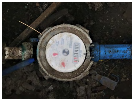
新たに設置されたメーター (事業範囲外)
