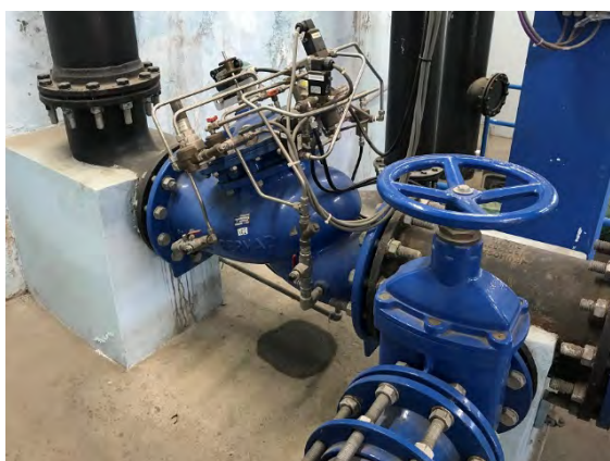
SCADA に接続された配水池のバルブ類
