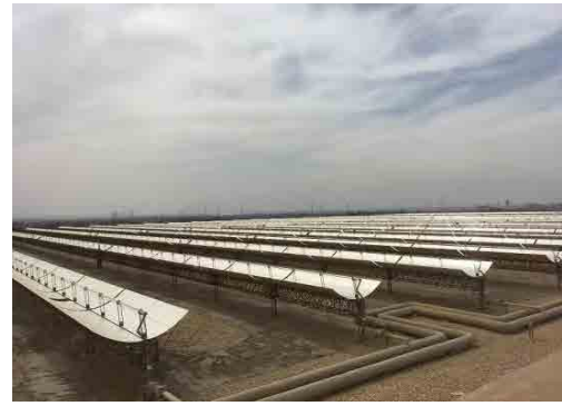
写真 2: 太陽熱集熱器
