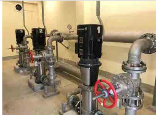
本事業で設置された送水ポンプ
