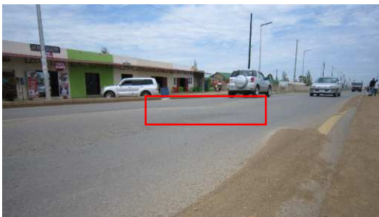
写真：道路不陸箇所の一つ (赤枠で囲った部分が沈んでいる)
