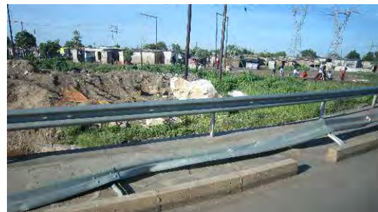
写真：壊れたガードレール
