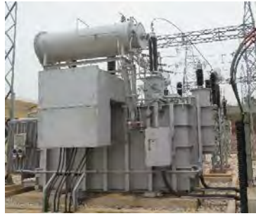
ムシャ変電所主変圧器
