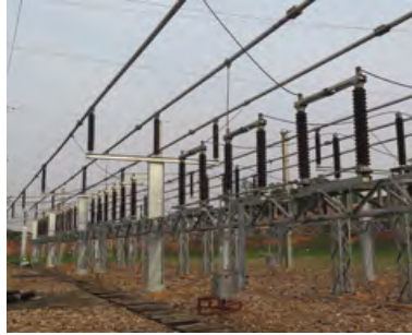
ギコンド変電所屋外開閉器
