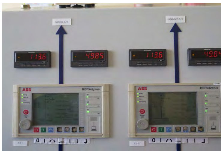
損傷した変電所コントロール室集中制御卓 (ムシャ変電所)
