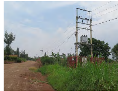
中圧・低圧配電線併架電柱 (キガリ市配電網)
