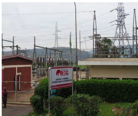
本事業で改修したジャバナ変電所
