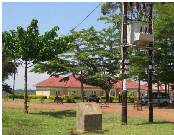
本事業で電化したナマインゴ県庁と変圧器
