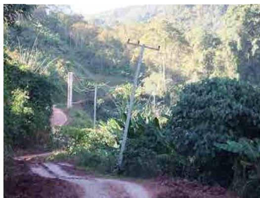
図3 傾きかけた電柱
