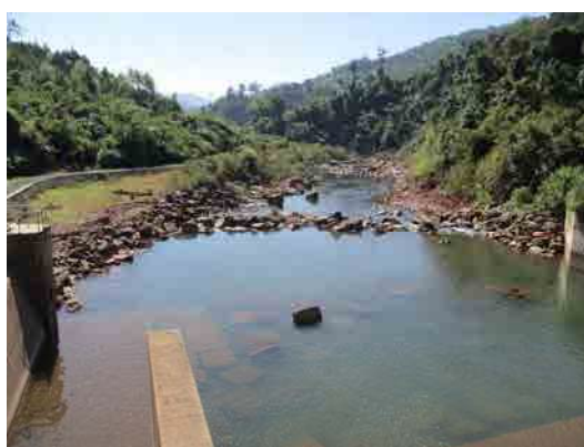
図2 流出した護床工ブロック
